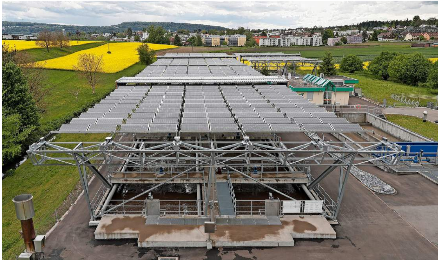
Das Solarfaltdach richtet sich automatisch optimal zum Sonnenstand aus und fährt zurück, wenn es durch die Witterung beschädigt werden könnte. Foto: Sibylle Meier
